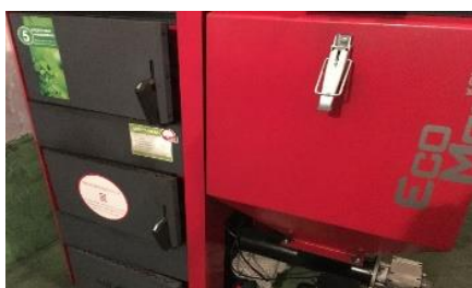
Wymiana źródeł ciepła w gminie Koniecpol i w roku 2018 z dofinansowaniem Wojewódzkiego Funduszu Ochrony Środowiska i Gospodarki Wodnej w Katowicach
